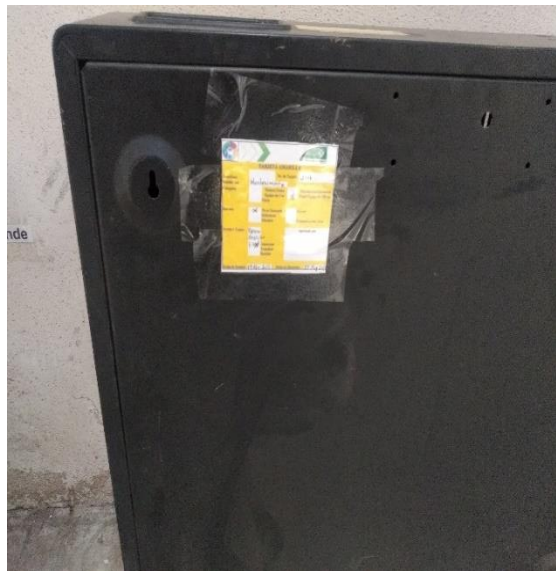
FIGURA 31. CALANTADOR DE GAS EN DESUSO
