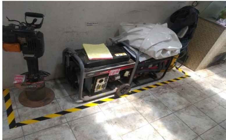
FIGURA 33. EQUIPO ELECTRICO EN SU LUGAR Y DELIMITADO
