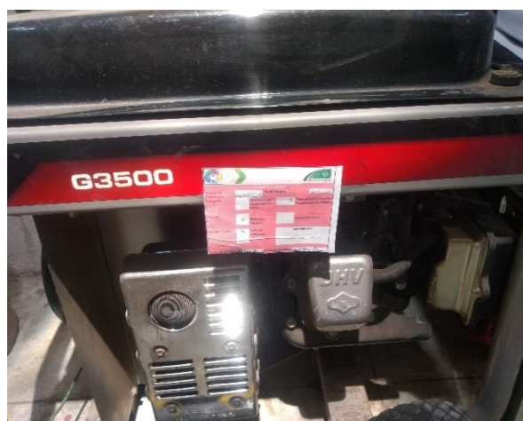
FIGURA 32. PLANTA DE LUZ DAÑADA
